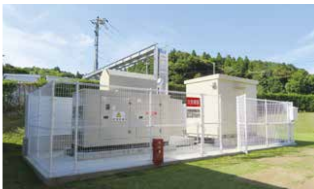
▲新たに設置された非常電源設備
